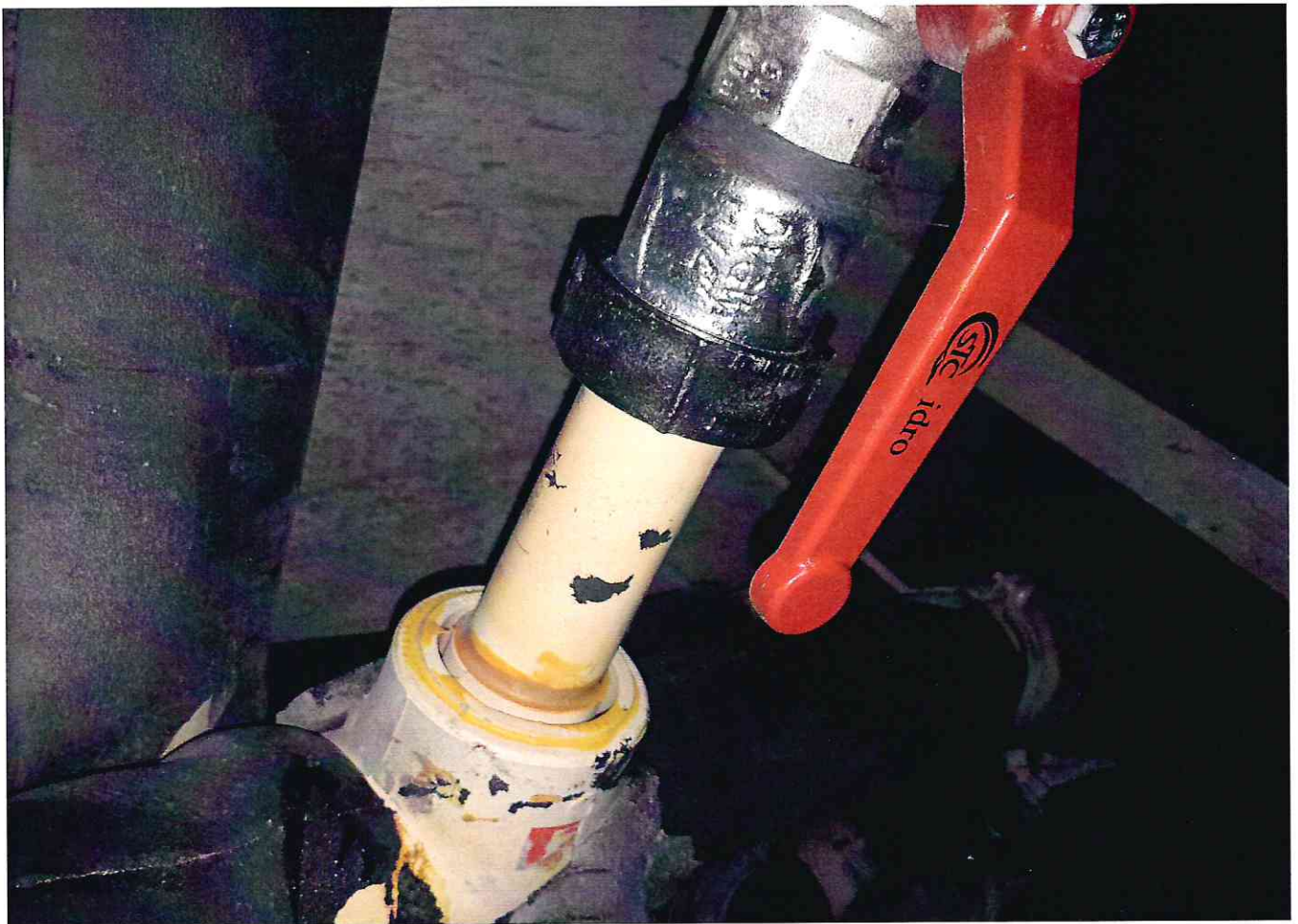
Пример разрушения ХПВХ трубопровода
