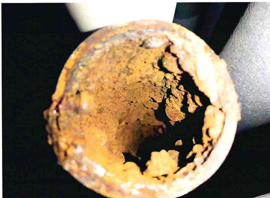
Коррозионные отложения оцинкованного стального трубопровода
